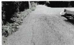
写真④ As舗装亀裂
