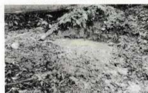
写真⑦ 地すべり地内湧水
