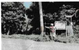
写真① 電柱傾倒状況
