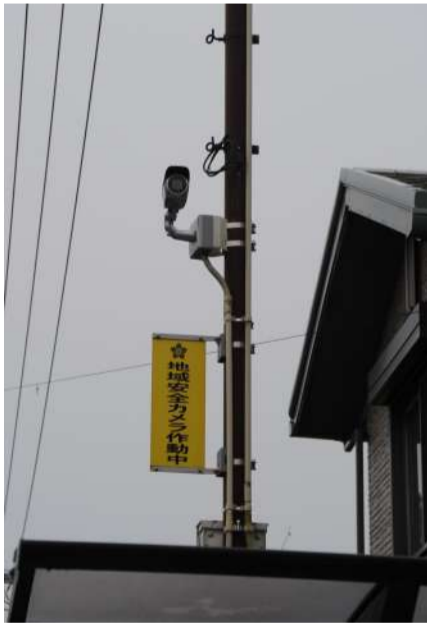
老朽化で更新される学区の地域安全カメラ
